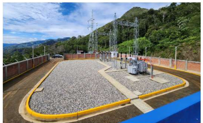
Subestación de transformación de Kiteni - La Convención
