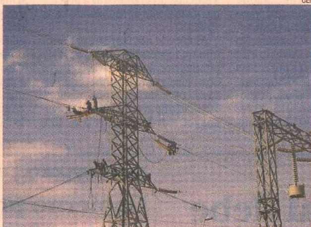
Demanda. Hay más necesidad de electricidad por parte de la población.
